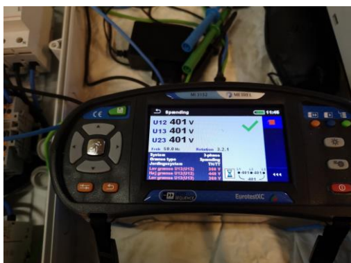
Rotation aflæses, og skal være det samme igennem hele installationen. Dette noteres som kontrolleret i din rapport.
