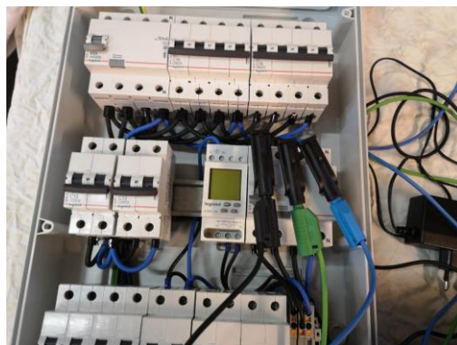
Prøvepindende monteres på L1, L3 og L3 i tavlen, CEE udtag eller andre tilslutningssteder. Herefter trykkes testknappe.
